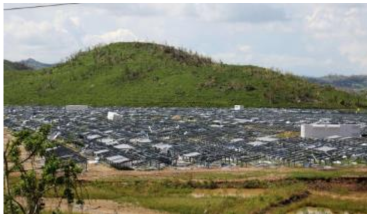
Figura 1. Efectos del huracán de gran intensidad María (2017) en el parque solar fotovoltaico Humacao, Puerto Rico.
